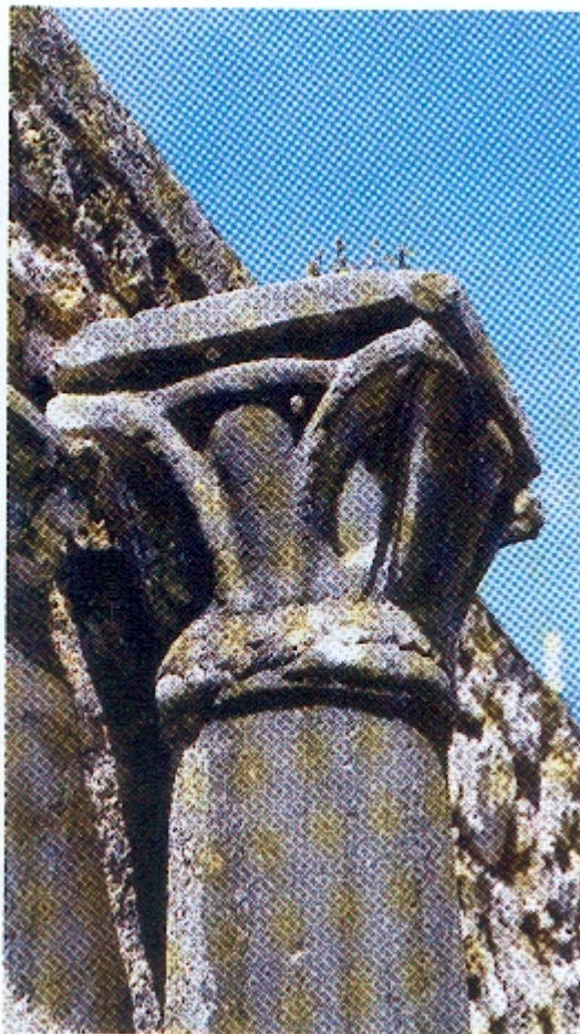
Macchie nere di origine biologica si trovano in posizioni frequentemente bagnate dove la formazione di croste di gesso e fuliggine è impossibile a causa del frequente dilavamento e aree bianche si trovano in zone asciutte non dilavate dove si aspetterebbero croste nere in caso di elevato inquinamento (Ravello, da Camuffo)
